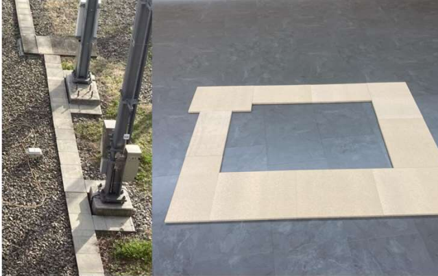
Abb. 1: Kabelkanal (links: real, rechts: Nachbau im Labor).
