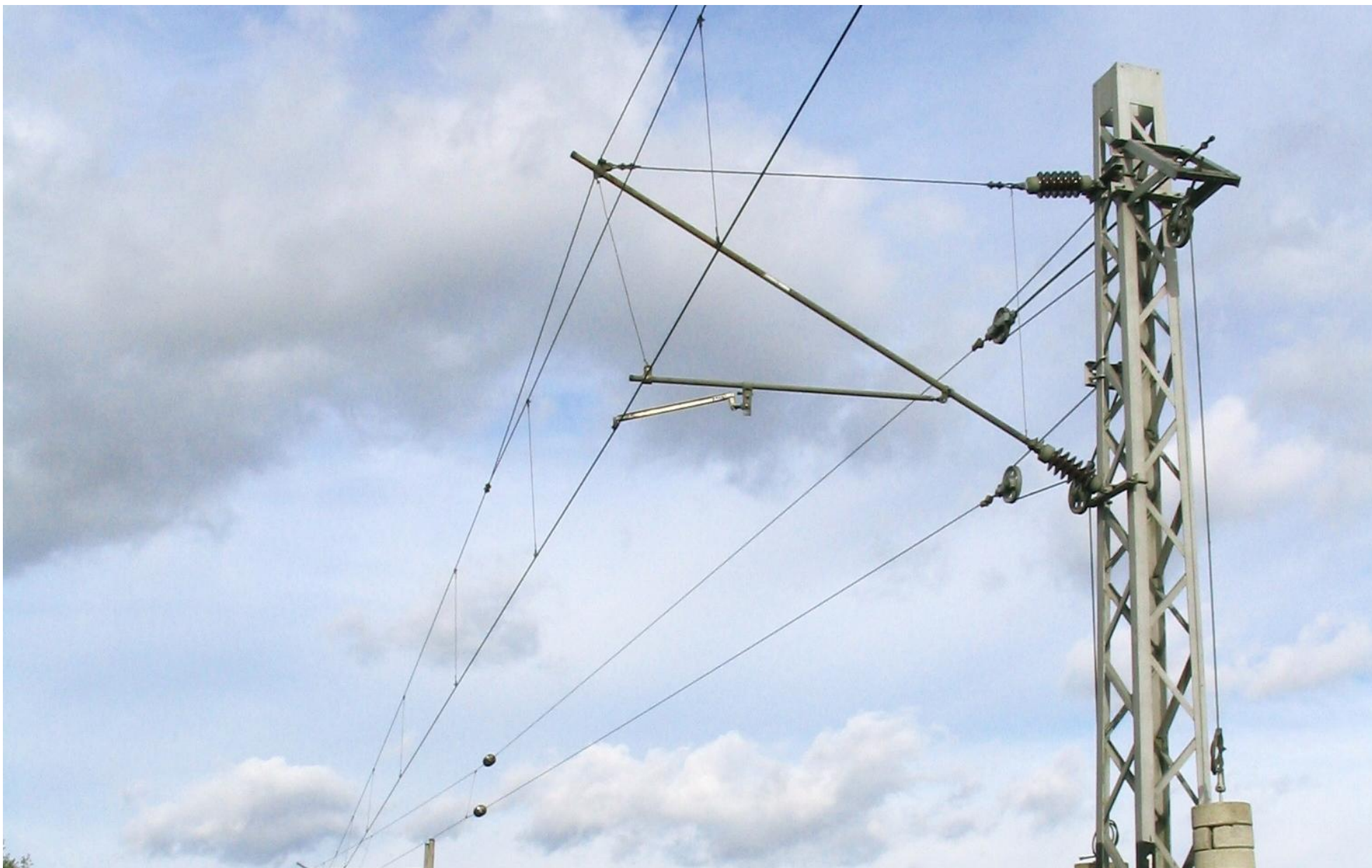
Abbildung 1: Kettenwerk mit Stützpunkt
