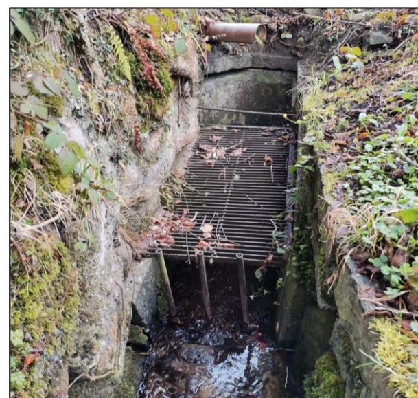
Abb. 1 Rechen in Meggen
