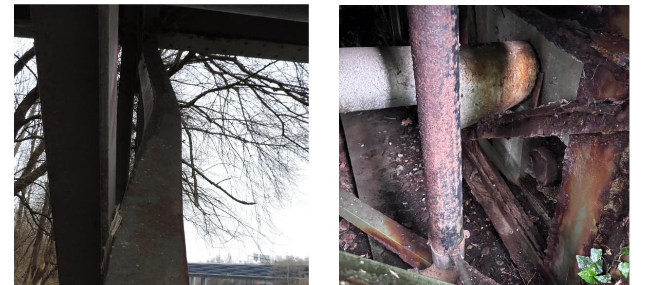
Abb. 4: Schäden am Tragwerk
