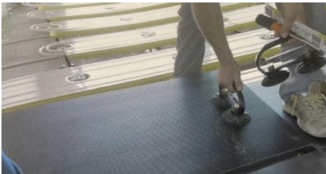
Abb. 1: Bereits vorhandener Doppelboden von DeltaZERO AG
