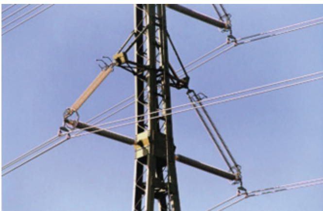
Abb. 1: Verbundisolatoren an einem Freileitungsmasten
