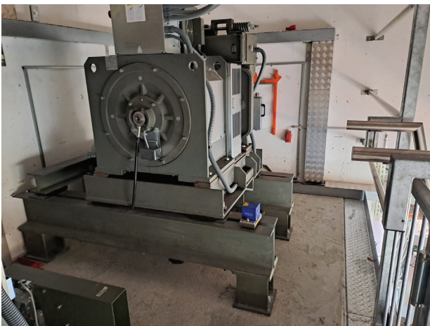
Abb. 1: Aufzugsmaschine PMR355 mit Messeinrichtung
