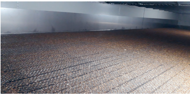
Abb. 1: Leere Trocknungskammer mit Schubboden, der aus Schlitzbrückenblechen besteht
