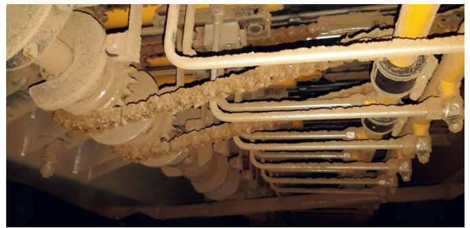
Abb. 2: Sicht auf den unter dem Schubboden liegenden Antrieb
