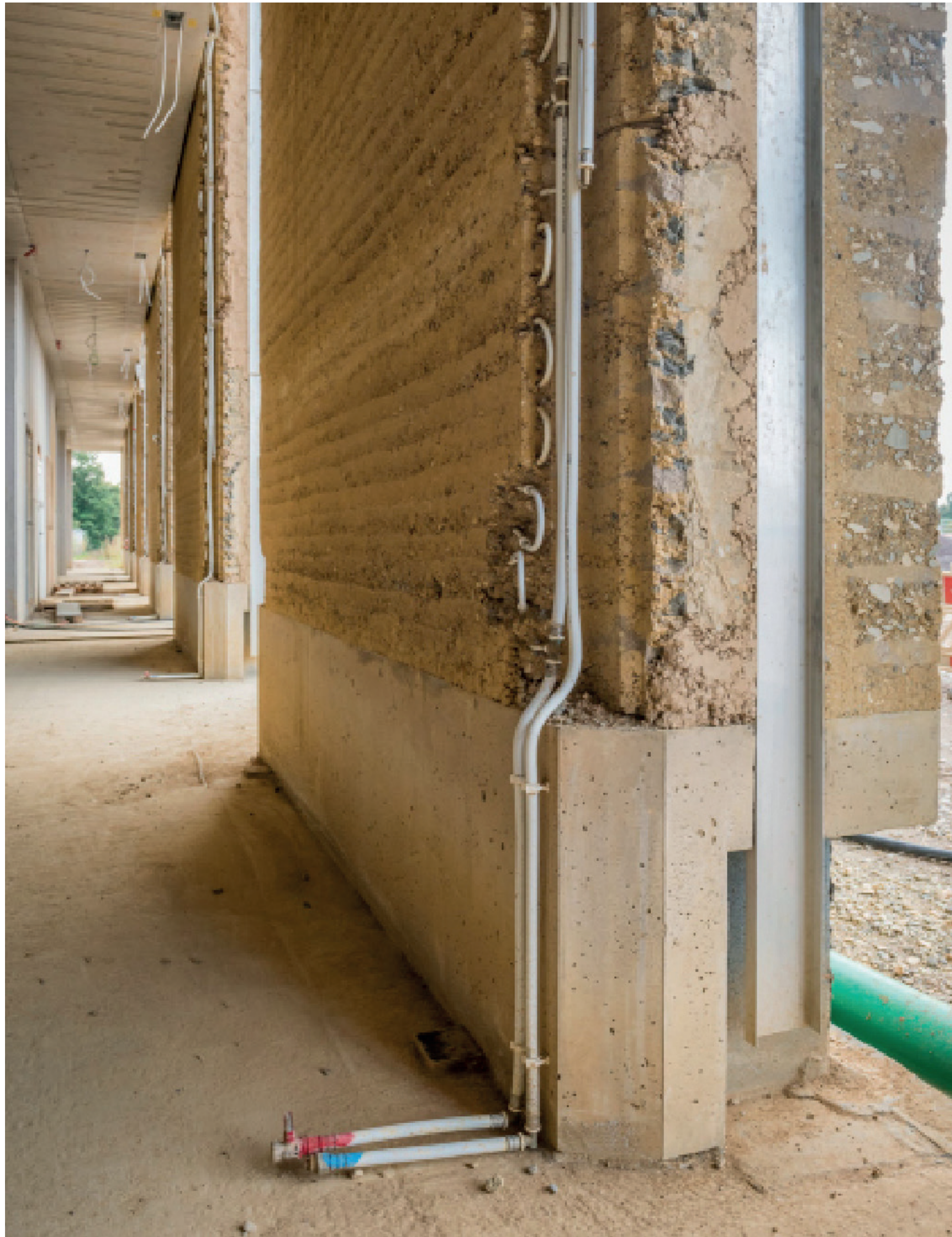
Referenzbild Wandheizung Foto: Marc Doradzillo, Darmstadt ca. 2017
