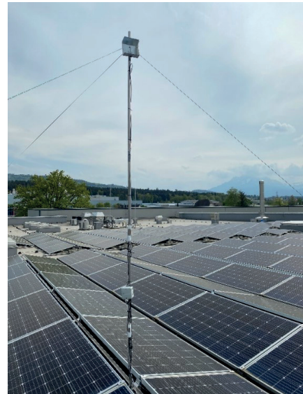
Abb. 2: Messeinrichtung auf der PV-Anlage der ALDI in Perlen LU
