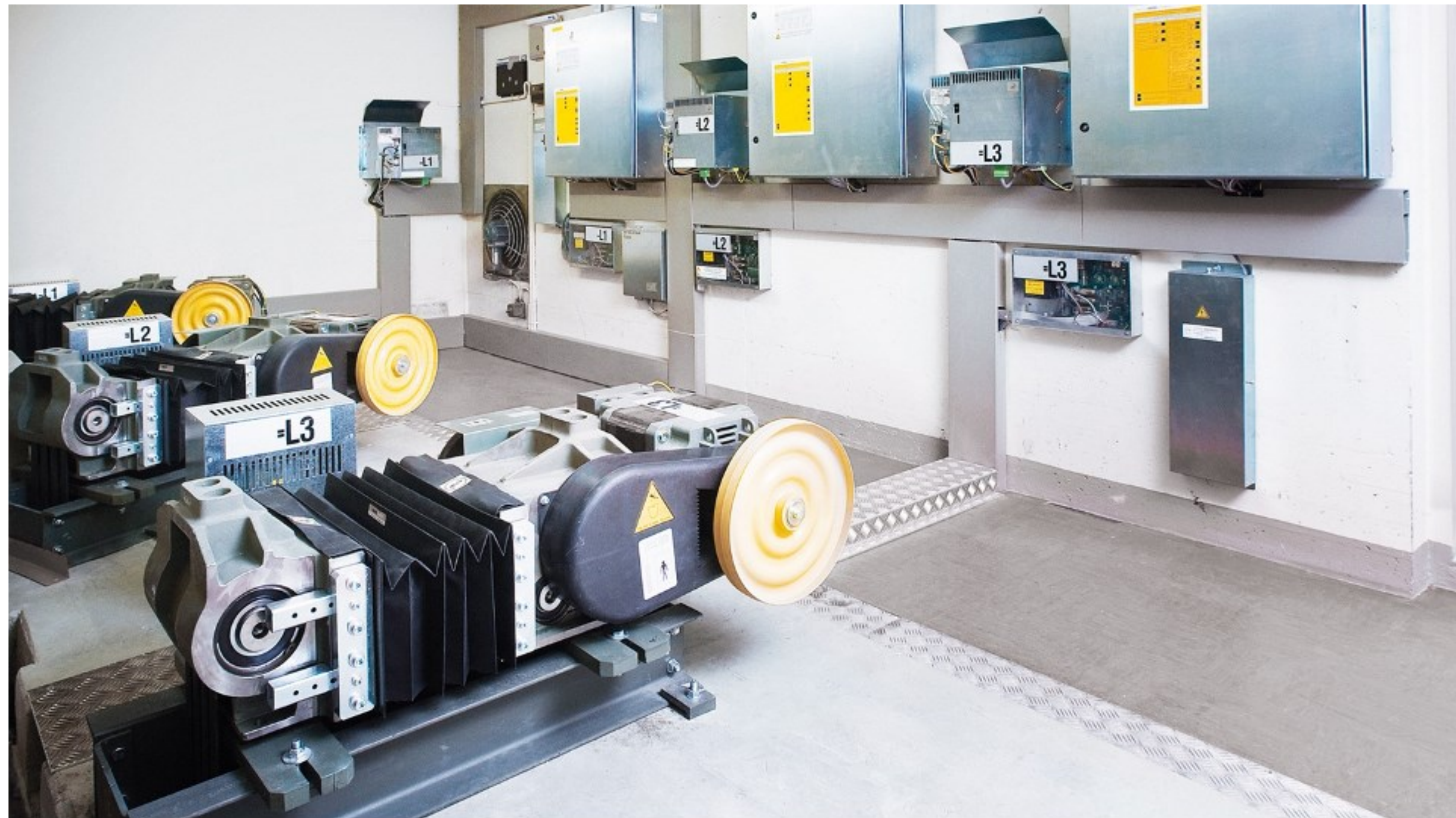
Abb. 01: Zweifache Liftanlage mit geteilter Schachtdecke
