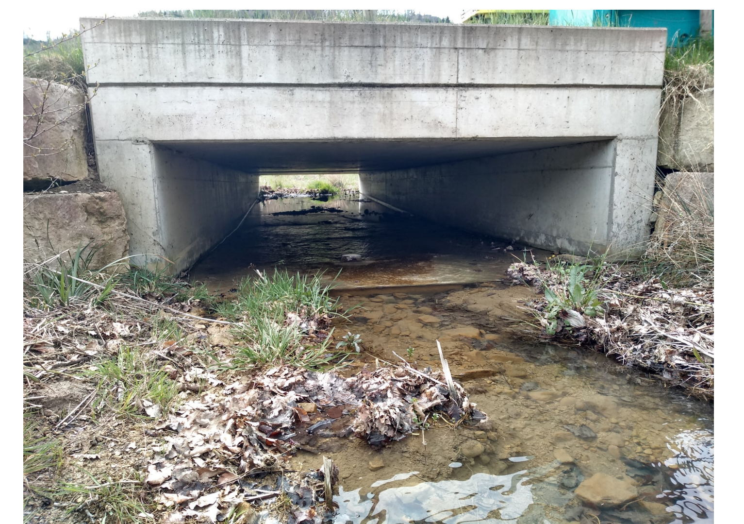
Abbildung 8: Ökologische Aspekte: zu hohe befestigte Sohle ohne Niederwasserrinne, Kolkbildung im Einlaufbereich, fehlende beidseitige Bankette (Murer, 2021)
