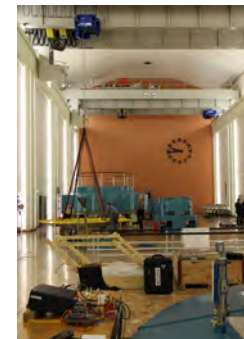
Abb. 14. Das Elektrizitätswerk in Göschenen ist bis heute einer der wichtigsten Arbeitgeber in Göschenen.
