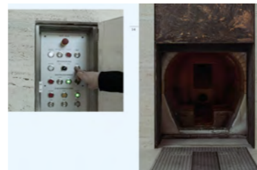
12 Steuerungskasten Kremation, 2022 13 Ofen, 2022
